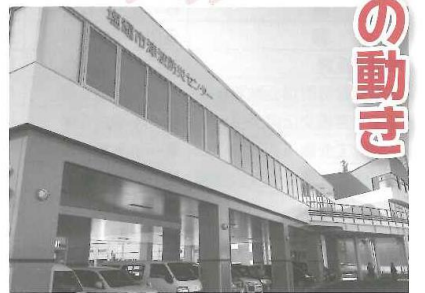
▲災害対応のための自家発電機等も常備されています
